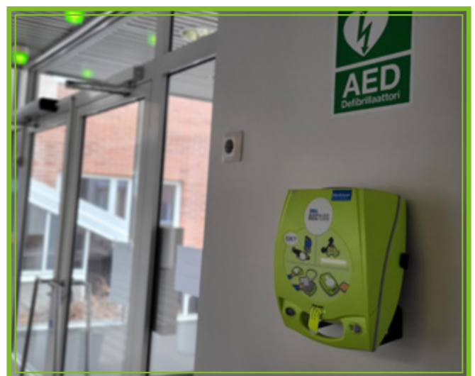
Esen toimipisteisiin asennettiin sydäniskurit vuonna 2022
