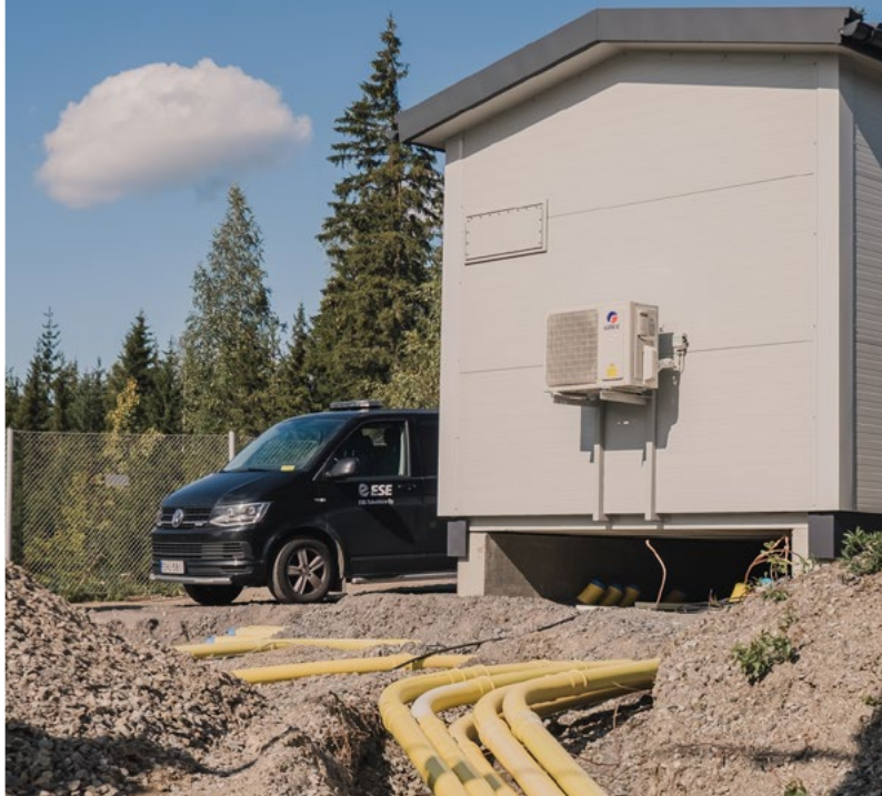
Kuvat: © Heidi Makkonen / Etelä-Savon Energia Oy
